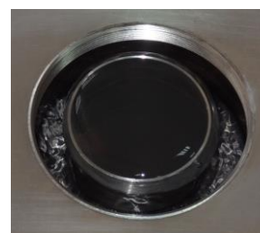
Поверхность теплоносителя (перелив)
